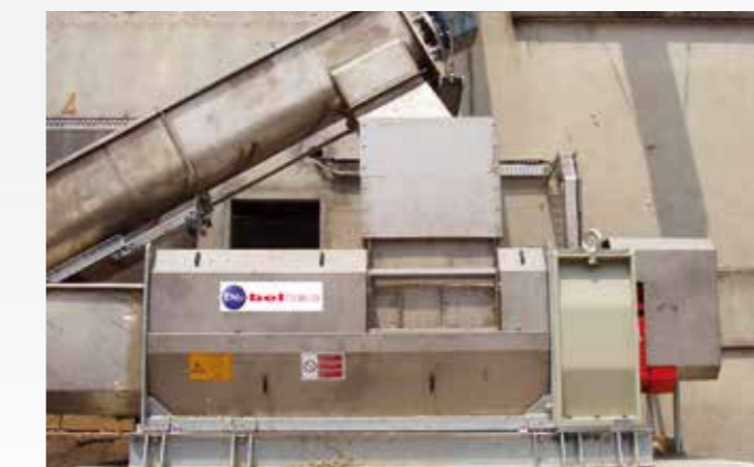
BP – Entwässerung von Pulper Spuckstoffen / BP – Dewatering of Pulper Rejects
