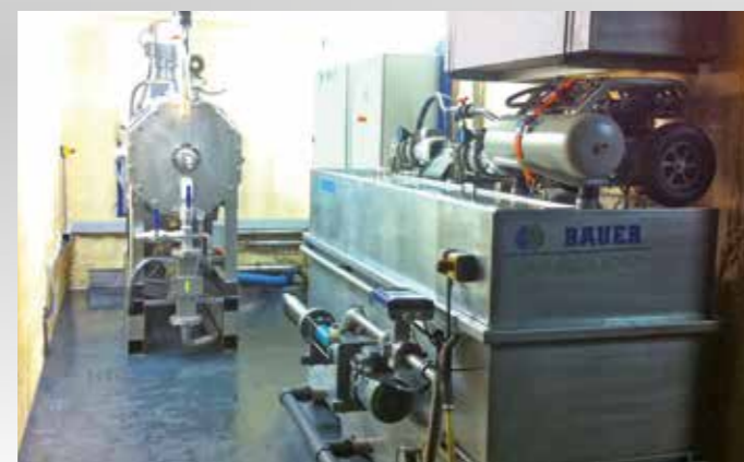
SPS – Schlammpresse mit Flockungsmittelstation / SPS – Sludge Press with flocculating aging station
